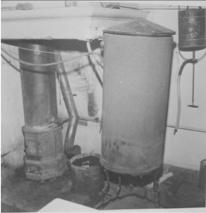
Avlusningsanläggning. Foto VLM
